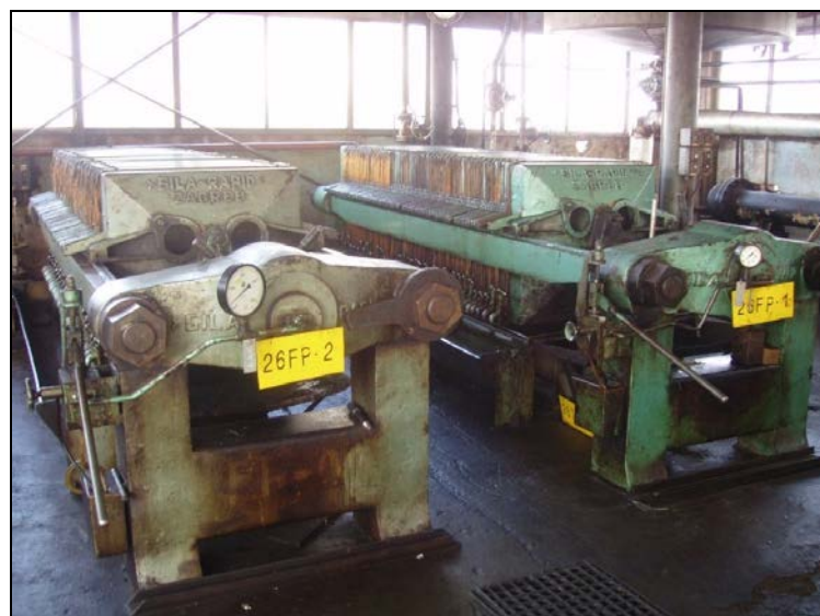
Slika 3. Ramska filter presa
